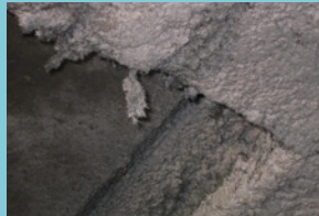
Rivestimenti in amianto spruzzato
