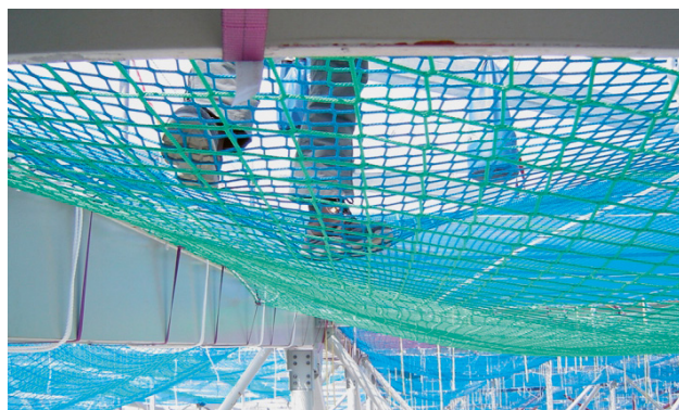
2 Durchhang beim Plattformnetz < 50 cm
