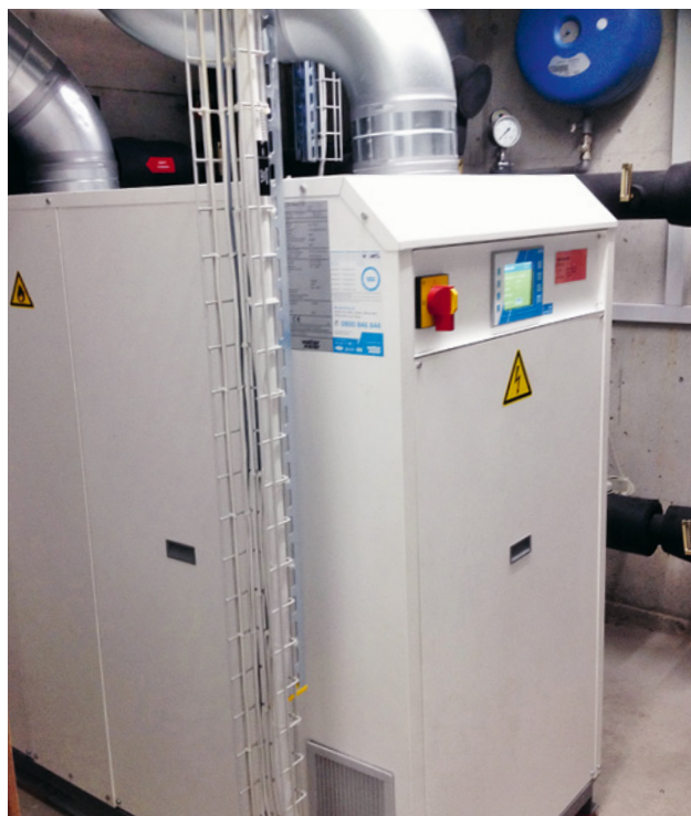
Sistema di refrigerazione in vano ventilato
