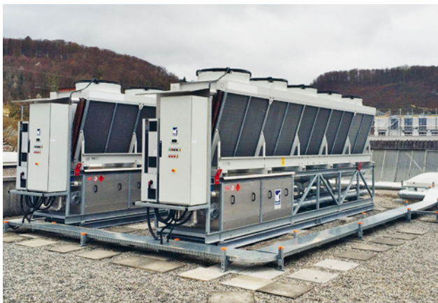
Sistema di refrigerazione all'aperto
