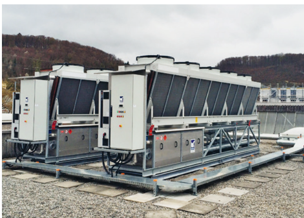
Sistema di refrigerazione all'aperto
