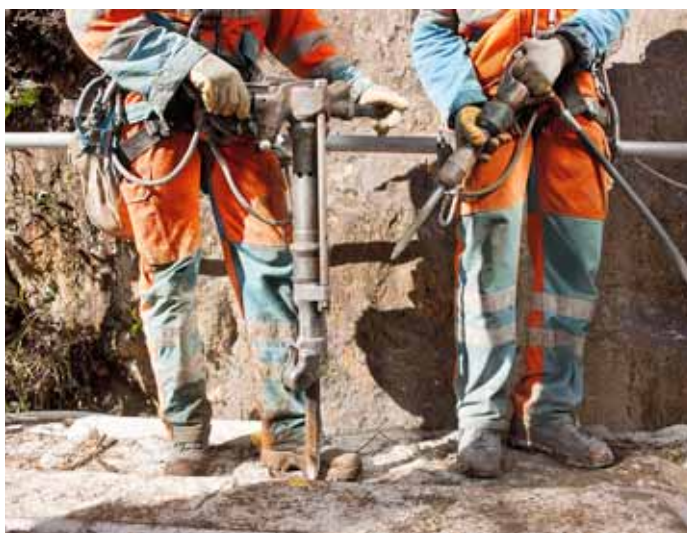
Image 8 il ne faut jamais utiliser des appareils trop puissants. Exemple: pas de marteaux brise-béton pour de simples travaux de bouchardage.
