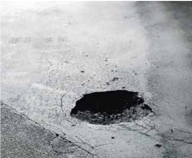
Image 20 les rainures, les trous et les seuils provoquent des expositions élevées aux vibrations pour les conducteurs.
