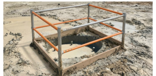
6 Les trous de forage ouverts doivent être sécurisés avec une couverture résistante et solidement fixée ou avec un garde-corps périphérique mobile.
