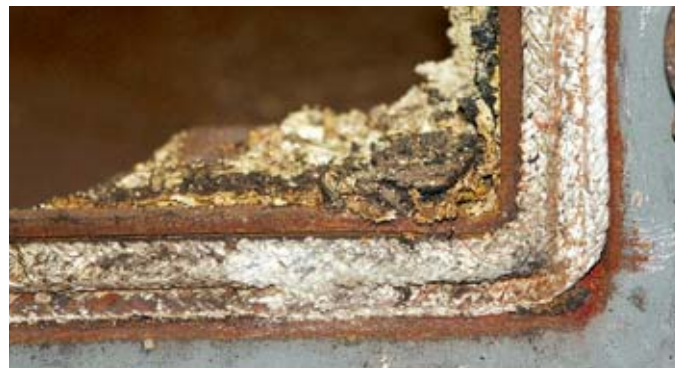
Cordone di amianto come guarnizione
