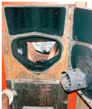
Cordone di amianto come guarnizione
