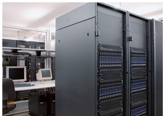
2 In Serverräumen werden Brände vermehrt durch eine sauerstoffreduzierte Atmosphäre vermieden.
