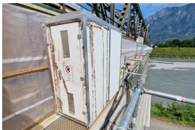
2 Unità di decontaminazione
