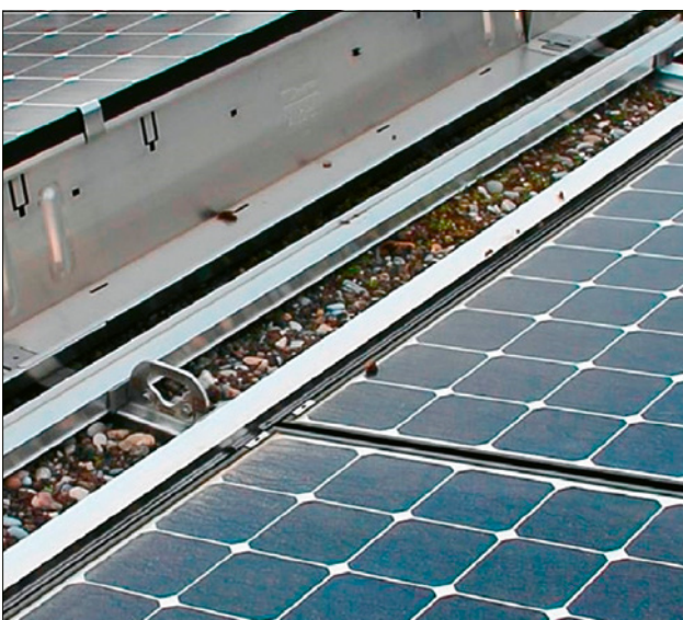
Point d'ancrage sur installation photovoltaïque
