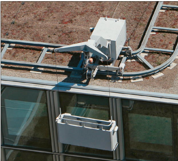
Installation de nettoyage de façades
