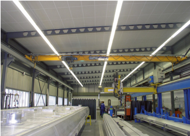
80 Plafond acoustique dans un atelier de soudage d'aluminium
