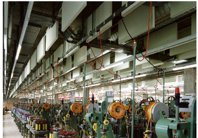
82 Plafond acoustique dans une entreprise de l'industrie textile
