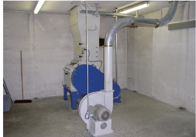
77 Broyeur de déchets de plastique dans un local séparé
