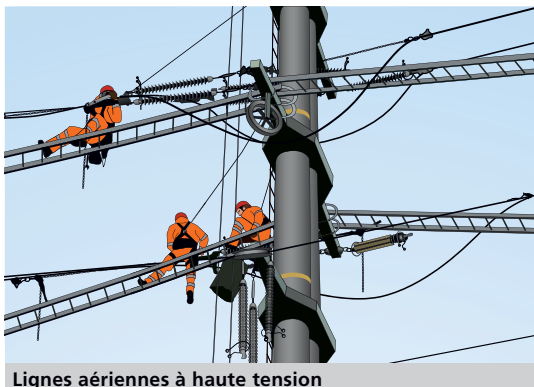
Lignes aériennes à haute tension
