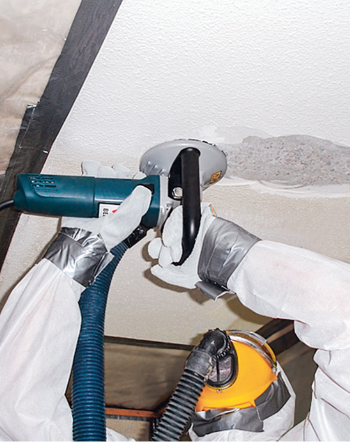
Durante l'abrasione di intonaci contenenti amianto, si ha un importante rilascio di fibre di amianto.
