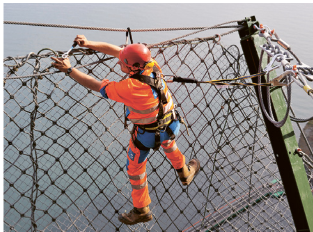
8 Messa in sicurezza con imbracatura anticaduta e fune di posizionamento. Fune di posizionamento provvista di moschettone di sicurezza per l'aggancio al punto di ancoraggio.
