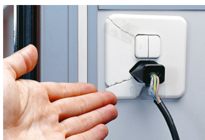
2 Enveloppe isolante endommagée et câble défectueux: risque d'électrisation
