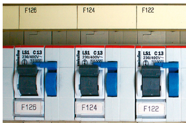
11 Disjoncteur en ligne
