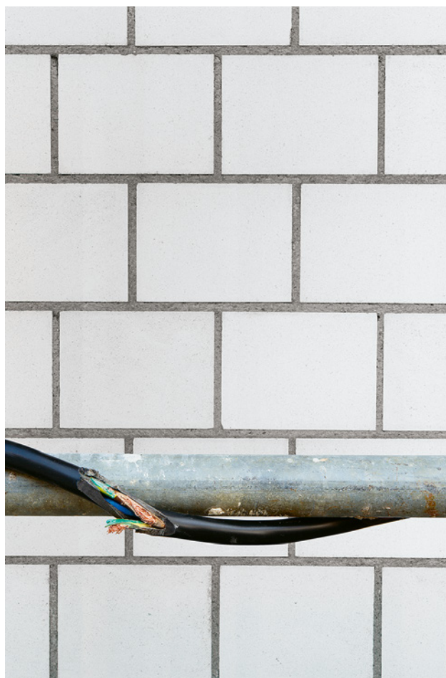
16 Il ne faut jamais utiliser des câbles ou des appareils défectueux!
