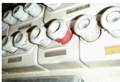
1 Tête de fusible en céramique endommagée: risque d'électrisation
