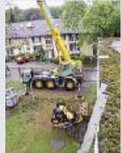
«Radlader über Dachkante gestürzt.» Beispiel auf www.suva.ch/unfallbeispiele
