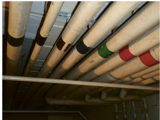
1 Isolamento fatto con un impasto di gesso contenente amianto
