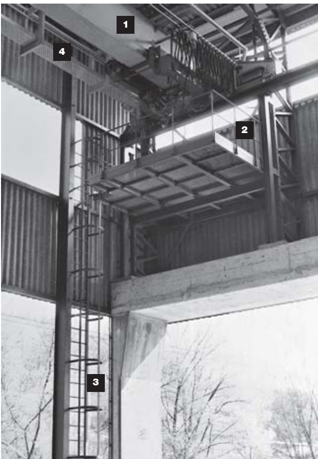
16 pont roulant monopoutre avec chariot-treuil suspendu. Une plate-forme est installée contre la paroi du bâtiment pour l'entretien du chariot-treuil suspendu et du treuil de levage. Il est ainsi possible d'accéder à toutes les parties à entretenir. La distance entre le point le plus bas des éléments fixes du chariot-treuil et le garde-corps de 1,1 m* de haut est de 0,5 m. La plate-forme est accessible par une échelle verticale avec protection dorsale.
