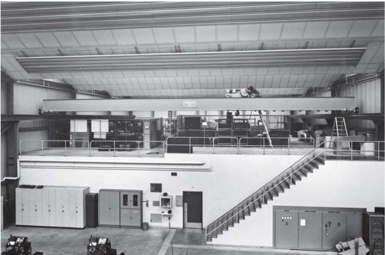
15 pont roulant bipoutre dont l'entretien peut s'effectuer depuis une grande plate-forme à l'aide d'échelles à crochets ou d'échelles doubles.
