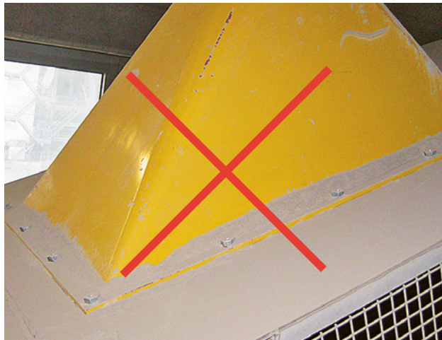
5 Accumulo di polveri: manutenzione insufficiente
