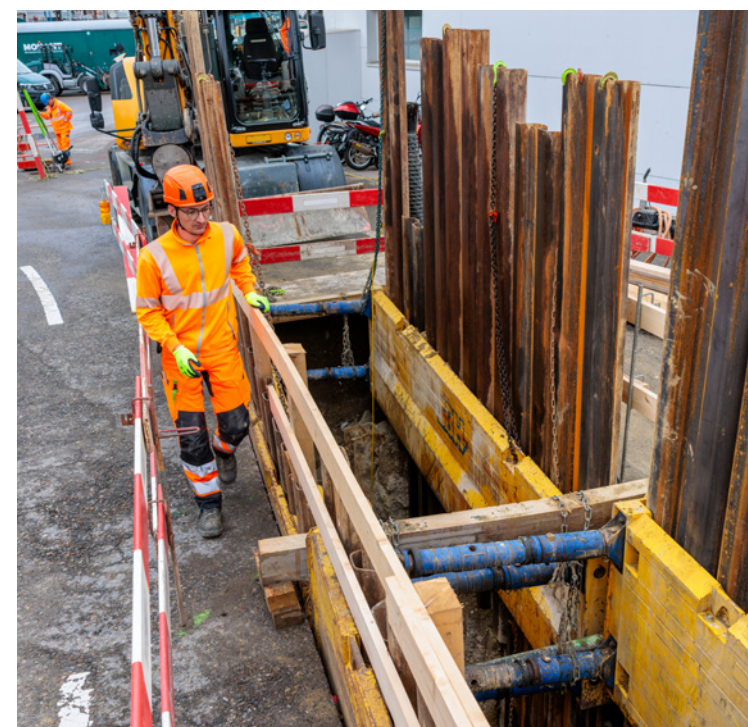
Regel 7: Wir sichern Absturzstellen für Personen und Fahrzeuge.
