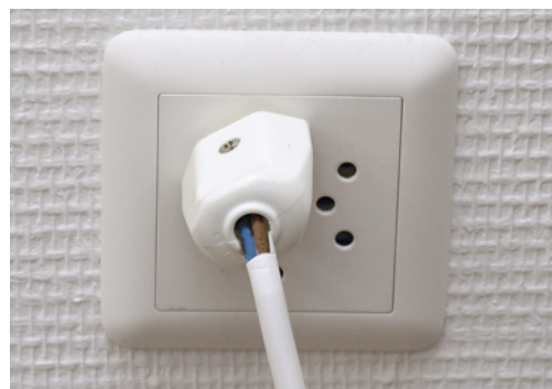
Fig. 22: remplacer immédiatement les câbles électriques défectueux.
