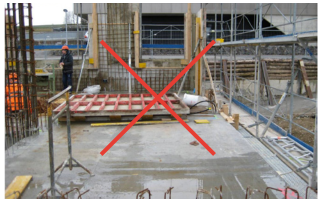
4 Als ein Monteur im oberen Bereich der Wandschalung etwas montierte, kippte das Element um und begrub den Mann unter sich. Abstützungen mit Deckenspriessen dürfen auf keinen Fall toleriert werden.
