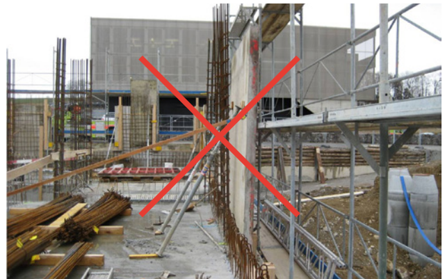
3 Wandschalungselemente, nicht wie vorgeschrieben zug- und druckfest verankert, sondern sicherheitswidrig mit zwei Deckenspriessen gestellt.
