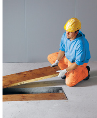
Regel 2 Bodenöffnungen sichern
