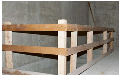
2 Absturzkante im Rohbau innen (z. B. Treppenöffnung)
