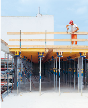
Regel 1 Absturzkanten sichern
