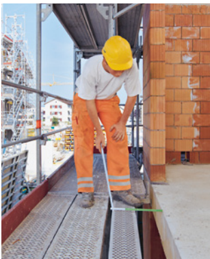
Regel 5 Täglich Gerüstkontrollen
