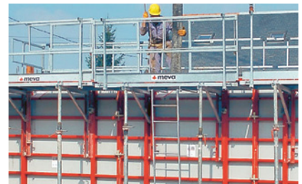
3 Absturzkante an Betoniergerüst
