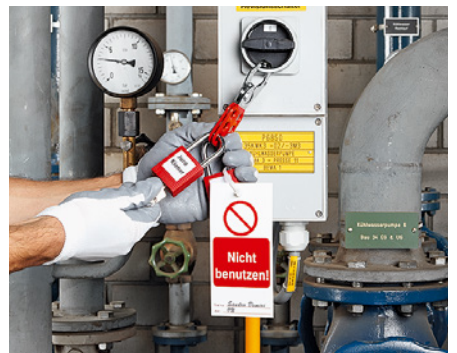
12 Étiquetage des dispositifs de consignation.
