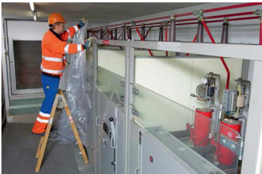
Nachgestellte Unfallsituation: Beim Montieren der Staubabdeckung gerät der Elektro-Lai (aus Unkenntnis) zu nahe an die rote 16 000-Volt-Stromschiene und wird schwer verletzt.
