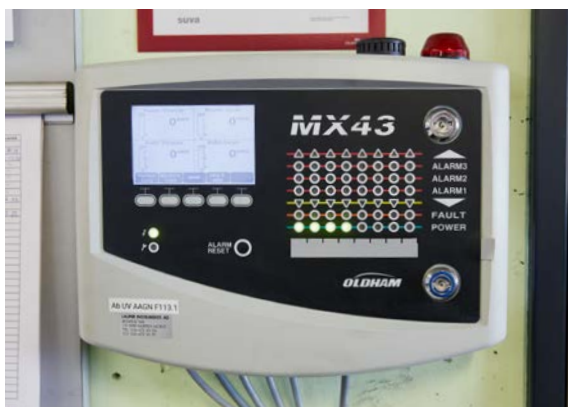
Gaswarnanlagen warnen vor explosionsfähigen Gaskonzentrationen.
