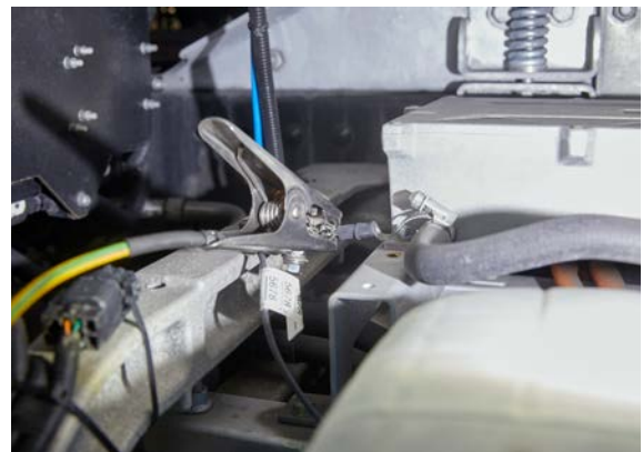
Ein geeigneter Potenzialausgleich verhindert elektrostatische Entladungen.
