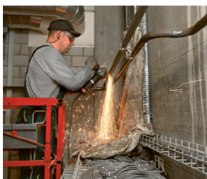
1 Protection des conduites électriques
