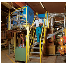
1 Plateforme fixe avec garde-corps
