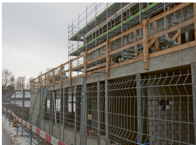
1 Protezione laterale a tre elementi installata come da norma SN EN 13374
