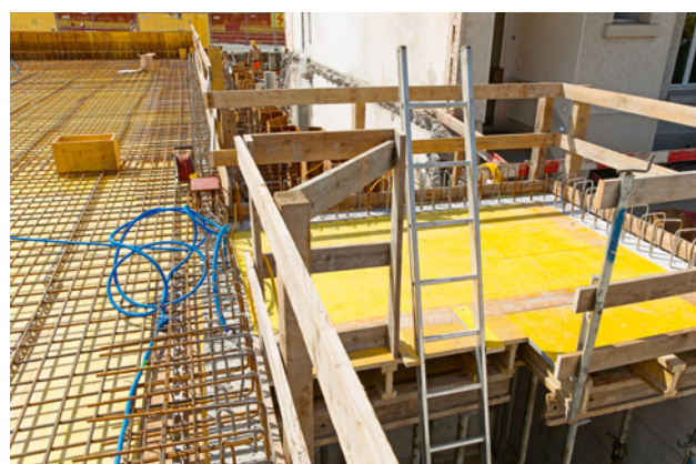
32 L'échelle dépasse d'au moins 1 m le point d'appui supérieur: l'accès est sécurisé.
