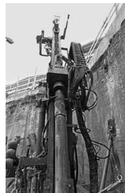
Bild 3: Bohrgeräte, die vor dem 10.3.2015 in Verkehr gebracht wurden, müssen beidseitig der Lafette mit einer Not-Halt-Einrichtung ausgerüstet sein.
