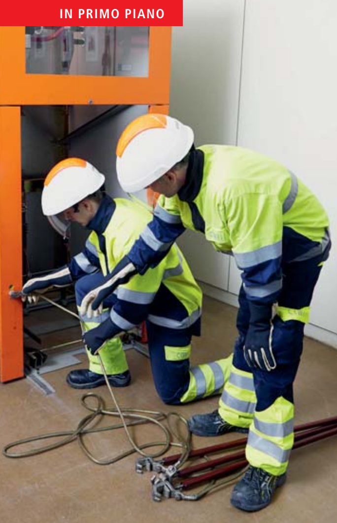
Robert Martinez, responsabile dei corsi e formatore presso la Centralschweizerische Kraftwerke AG spiega a un apprendista le regole di sicurezza e le tecniche di lavoro nel settore elettrico.
