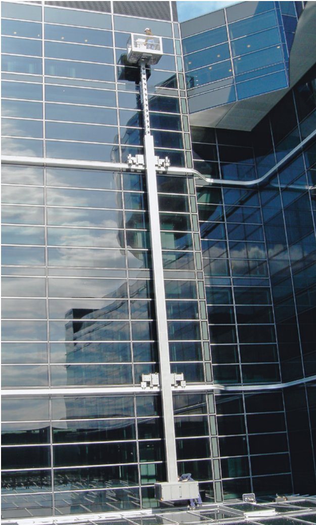
13 Plateforme élévatrice mobile de personnel sur mât télescopique vertical pour le nettoyage des vitrages d'un bâtiment.
