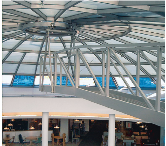
14 Pont mobile dans un édifice circulaire. Cette installation permet d'effectuer les travaux de nettoyage et d'entretien de la face interne des toitures vitrées.
