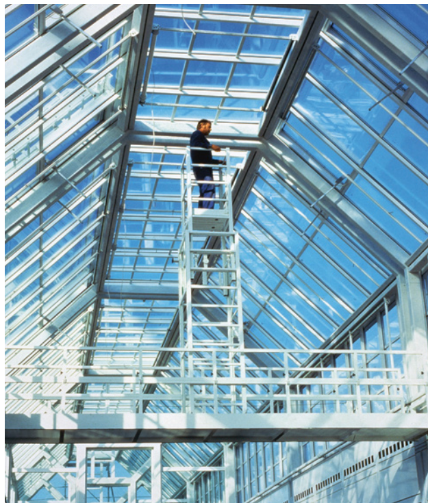
9 Pont mobile avec tour mobile latéralement et verticalement dans une halle vitrée. Cette installation permet de nettoyer aisément et en toute sécurité l'ensemble des surfaces vitrées.
