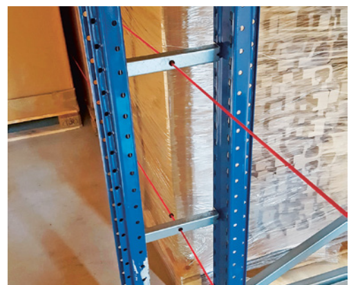
3 Lagerregale müssen bis auf mindestens 1m Höhe mit Absperrungen (Regalprofile, Ketten, Drahtgittern oder Drahtseilen) gegen ein Durchsteigen gesichert sein (lichte Öffnungen vertikal max. 0,5m).
