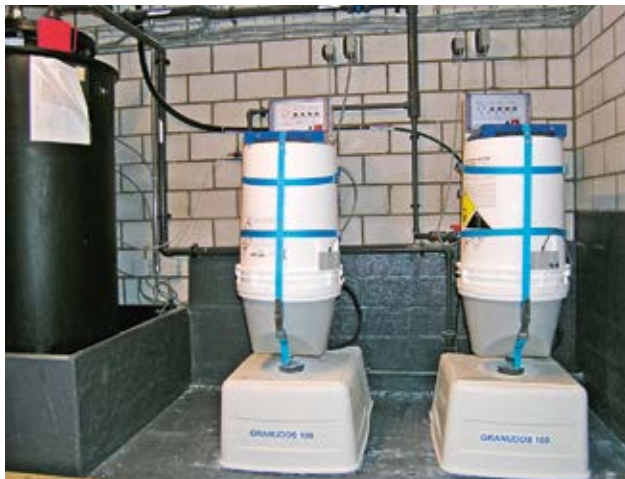
Fig. 1 Station de dosage d'hypochlorite de calcium. Il est ainsi possible de renoncer au stockage et à l'utilisation de chlore dans des réservoirs sous pression.
