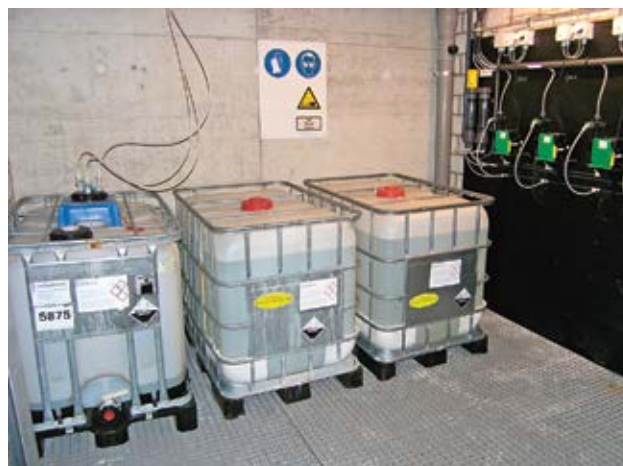
Fig. 3 Vue d'un local séparé pour le dosage d'acide. Le sol est conçu comme un bac de rétention; dans le coin, le canal d'évacuation de l'air vicié de la ventilation artificielle du local.
