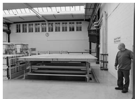
Fig. 7: l'operatore ha la visuale libera sulla zona di pericolo della cabina in fase di discesa. La discesa del tetto della cabina si arresta automaticamente a 120 mm sopra il bordo della fossa del vano.
