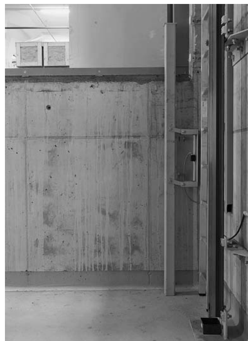
Fig. 3: dispositivo ad azionamento manuale (sostegno per lavori di manutenzione) presso un ascensore, qui con fossa del vano di corsa
