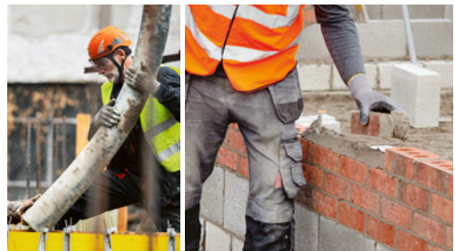
2 und 3 Vor allem Maurer, Bauarbeiter und Plattenleger haben häufig Hautkontakt mit nassem Zement.
