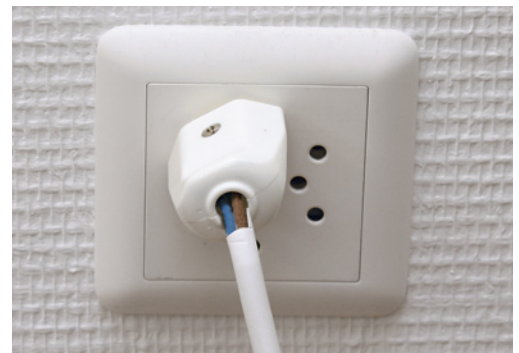
Bild 22: Defekte Elektrokabel umgehend ersetzen.
