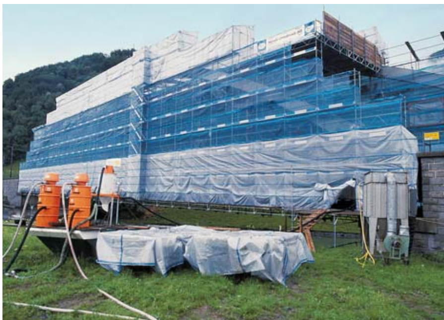
Protezione antipolvere presso un ponte metallico. In basso è visibile il sistema di aspirazione e di abbattimento della polvere.
