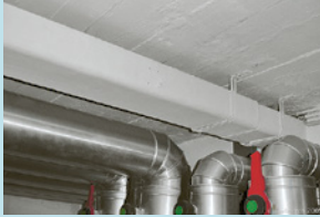
Kabelkanal aus Asbestzement
