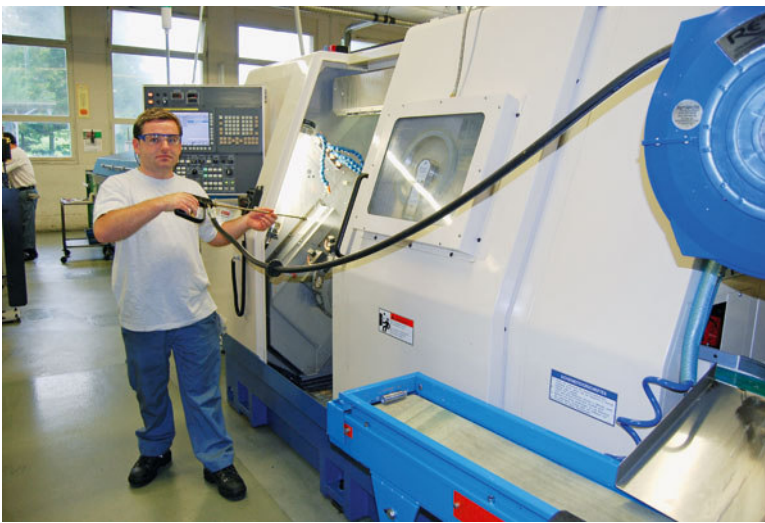
Plus de risque de trébucher, le dérouleur du tuyau de soufflage est maintenant placé en hauteur.
