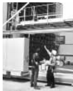
Figura 3: eliminazione guasti. Discutere e pianificare gli interventi più delicati.
