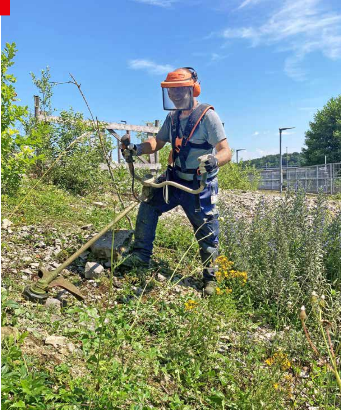
Erhöhte Stolpergefährdung besteht bei der Arbeit im Gelände.
