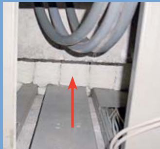
Brandabschottung mit Asbestkissen
