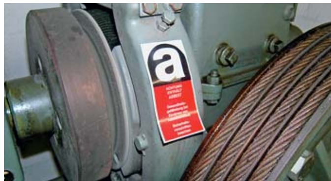
Bremsbeläge an einem alten Liftmotor
