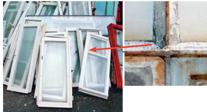
Der Fensterkitt enthält festgebundenen Asbest
