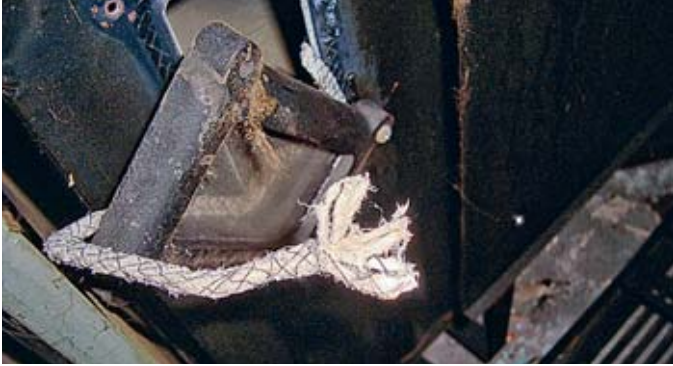
Asbestschnur als Dichtung an einer Anlage
