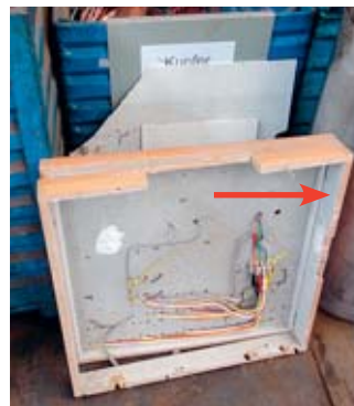
Leichtbauplatten bei Verteilern und Leuchten
