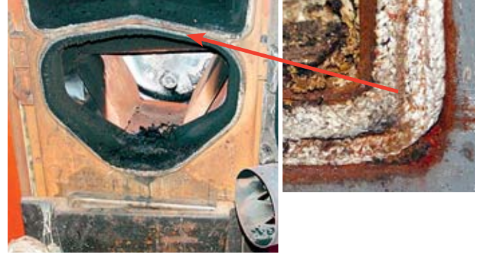
Asbestschnur an Heizkessel
