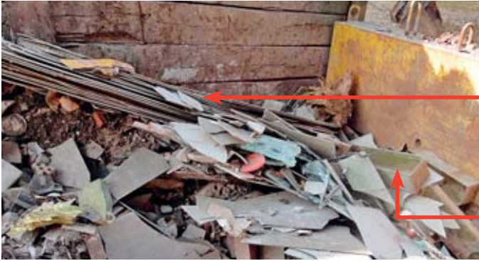
Dachplatten, Pflanzgefässe und Teile von Asbestzementrohren in gemischten Abfällen
