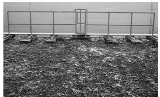
6 Point de sortie protégé des deux côtés par des garde-corps le long du bord de chute.
