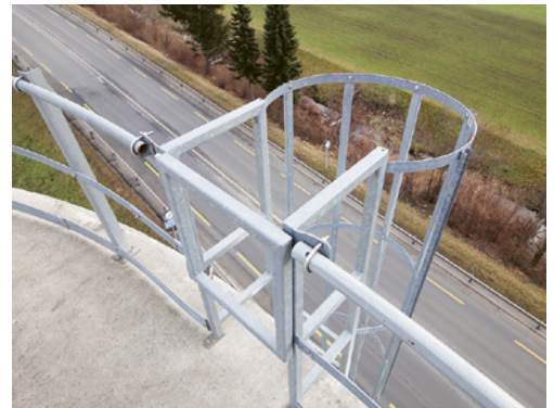
5 Le point de sortie de l'échelle est protégé par un portillon à fermeture automatique.
