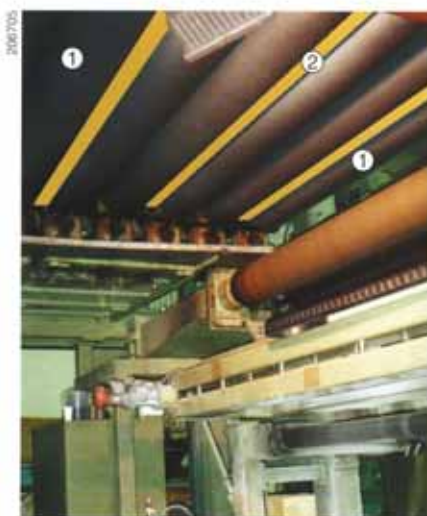
Figura 20: calandra in un'azienda della lavorazione di materiale sintetico. Zone d'imbocco dei due rulli di raffreddamento (1), raggiungibili con le mani, protette con barre sensibili (2).
