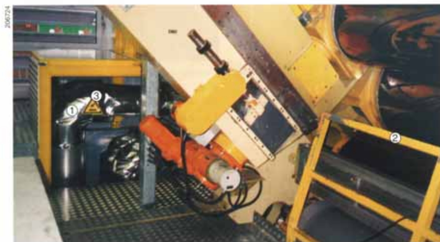
Figura 42: calandra in un'azienda per la lavorazione di materiale sintetico. I tubi di riscaldamento (1) dei cilindri della calandra sono isolati. Un parapetto (2) impedisce la caduta sui cilindri caldi. Il cartello «Attenzione, pericolo di scottature al contatto con oggetti caldi.» (3) avverte del pericolo delle superfici calde.
