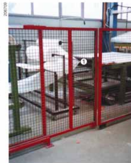
Figura 25: la zona di pericolo di tutti gli elementi di questo impianto e le zone d'imbocco dei cilindri (1) sono protette per l'esercizio normale con un recinto e con un porta d'accesso provvista di un dispositivo di blocco (ripari di segregazione asserviti).
