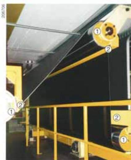
Figura 21: impianto di rivestimento in un'azienda della lavorazione di materiale sintetico. Zone d'impatto ai cilindri di rinvio (1) protette con barre sensibili (2).
