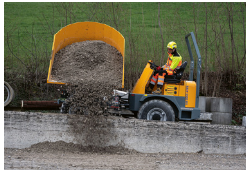
3 Kippstelle mit Anfahrtschutz (mindestens 1/3 der Radhöhe), damit ein Überfahren der Kante verhindert ist.
