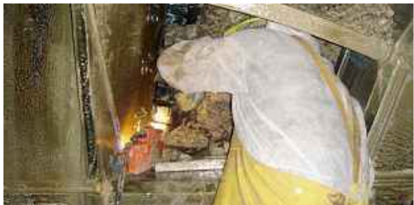
Werkzeugwechsel am Schneidrad: Schwerarbeit unter Überdruck im feuchtwarmen Klima der Arbeitskammer einer Tunnelbohrmaschine.
