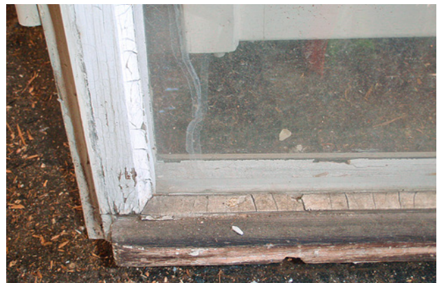
1 Asbesthaltiger Leinölkitt an einem Holzfenster
