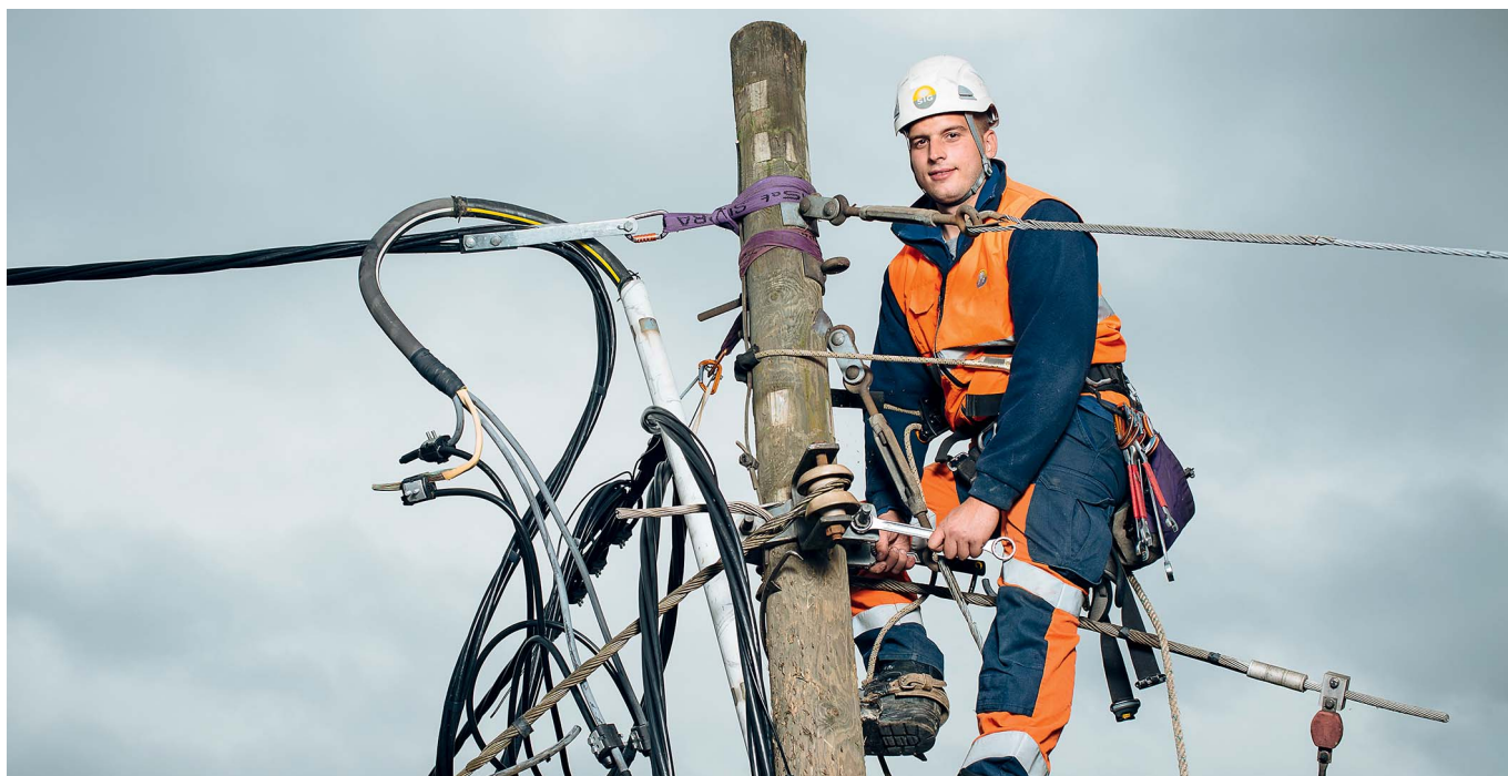
Anche sui pali della luce va rispettata la sicurezza sul lavoro: un lavoratore della SIG all'opera.
