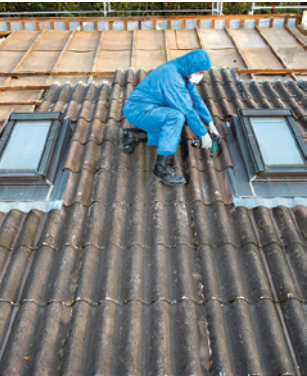
Regola 9 Proteggersi dalle polveri di amianto
