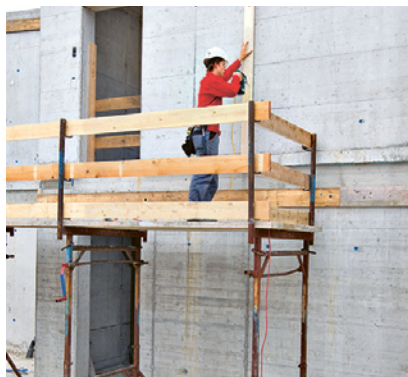
2 Ponteggio a cavalletto con protezione laterale corretta
